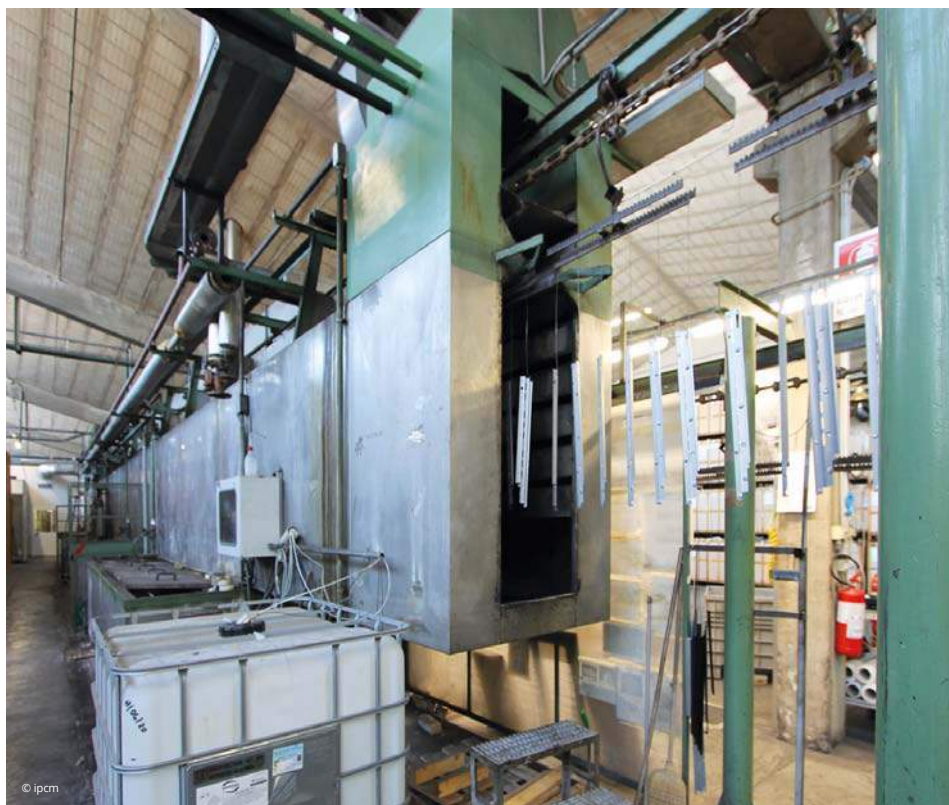
Il tunnel di pretrattamento.
