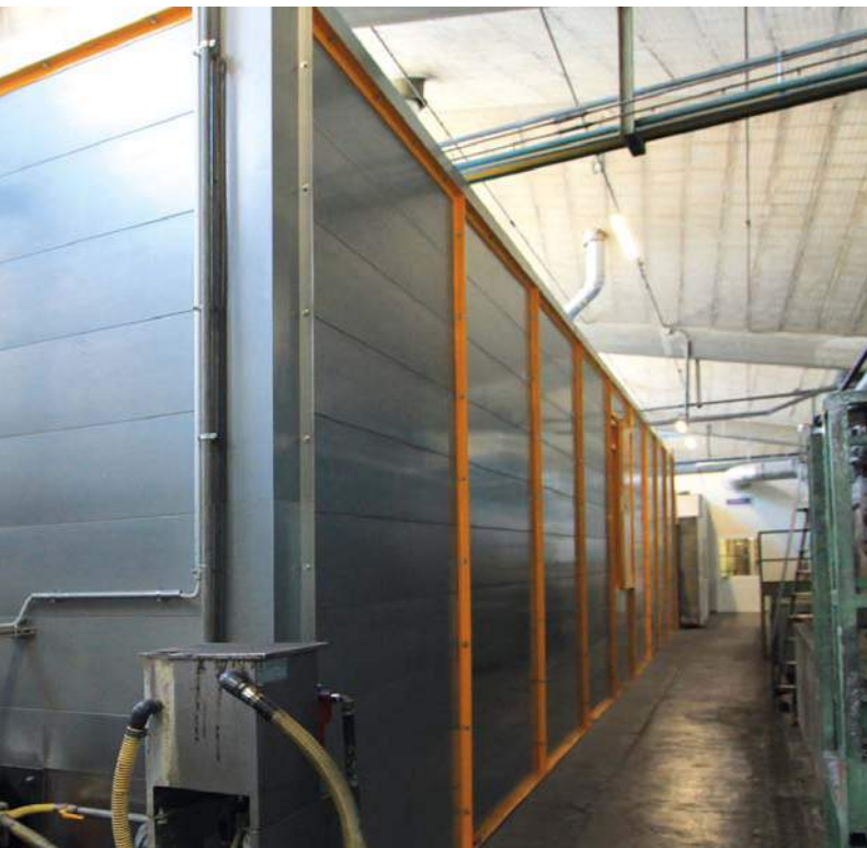
Il nuovo forno di polimerizzazione installato da Euroimpianti.
