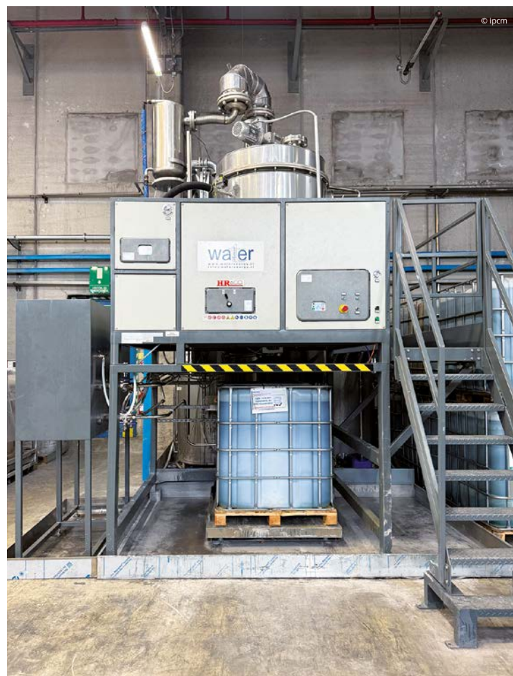
Water Energy ha proporcionado una instalación para la destilación de los disolventes utilizados en la limpieza de los equipos de aplicación del recubrimiento.
