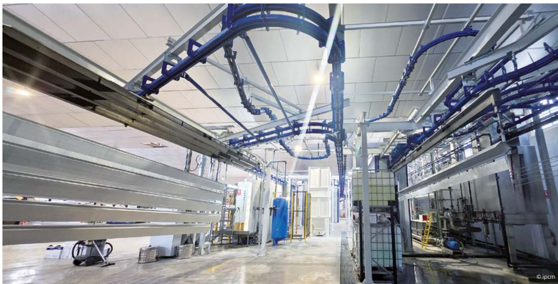
Vista general de la instalación suministrada por Cabycal.
